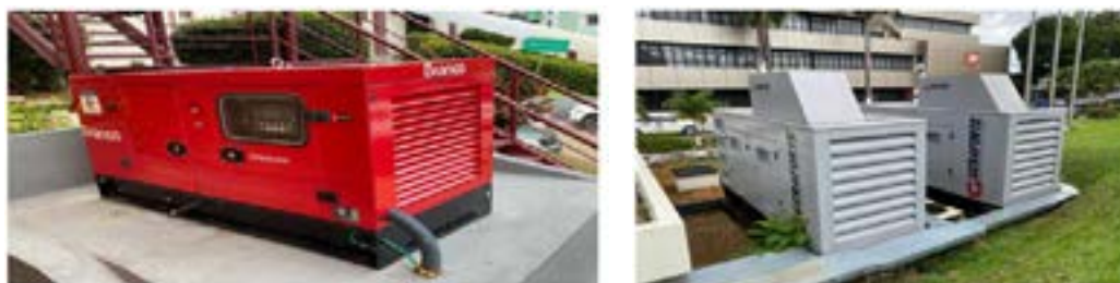
Figura - Geradores de Energia
