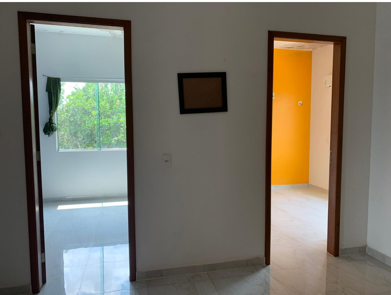
(FIG. 16 VISTA SUPERIOR DA CASA) A PARTE SUPERIOR CONTA COM 3 COMODOS, SENDO UM DELES COM BANHEIRO INTERNO E CLOSET DE APROXIMADAMENTE 3,5 METROS POR 3 METROS E UM BANHEIRO EXTERNO
