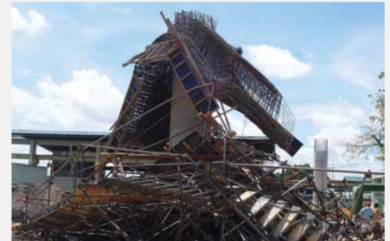
Investigação após acidente no complexo em construção da Bola do Coroado apontam irregularidades na licitação, elaboração e execução do Complexo Viário Ephigênio Sales
